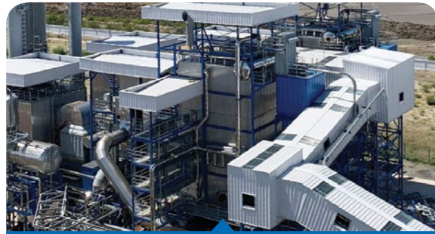
Lò hơi tầng sôi tuần hoàn (CFB)
