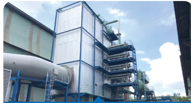
Lò hơi thu hồi nhiệt (HRSG)
